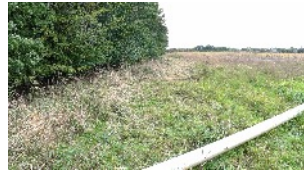
FPA3 metal pipe at A1 end
